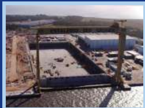
Estaleiro Rio Grande Rio Grande/RS Automação Comporta do Dique
